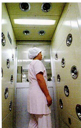
厨房のエアークリーンシャワー
